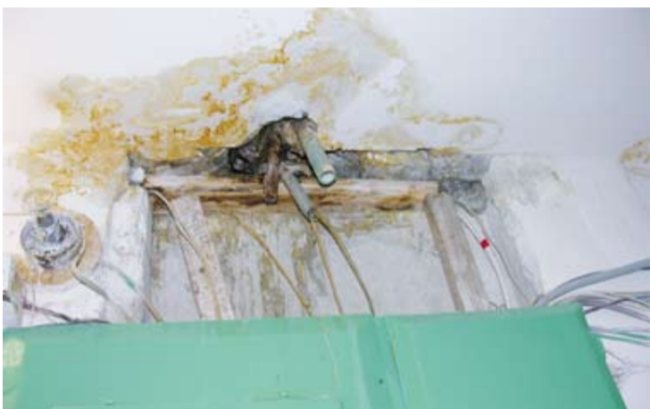
Вода с потолка поступает прямо в электрощит.
